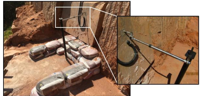
Figura 10. Instrumentado instalado no ponto 4.
