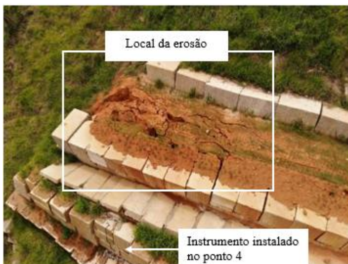
Figura 14. Identificação da erosão próximo ao ponto 4.
